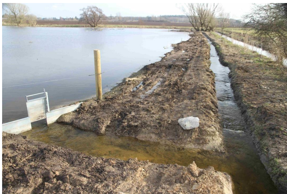
Foto 1. Et af de nye justerbare afløb fra gedde-engen i medio marts 2024 ved moderat vandføring.
