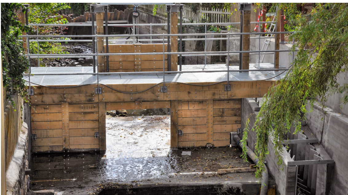
Frislusen tørlagt i forbindelse med renovering. Bemærk fast bund og sider.
